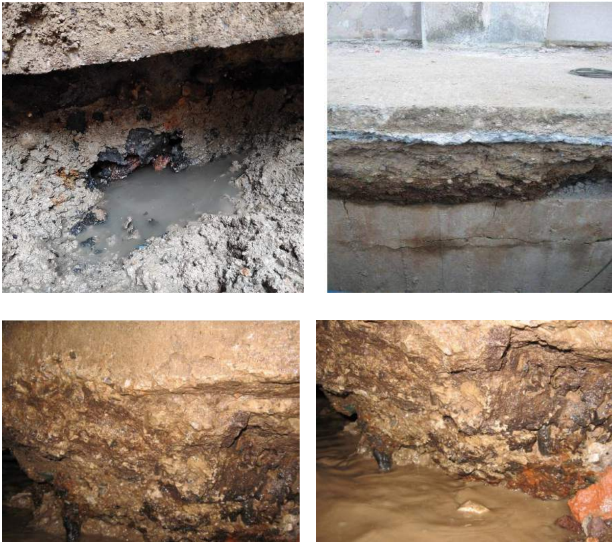
Şekil 16: Kazıkların başlık alt bölgelerinde gözlemlenen korozyon (DEÜ Raporları, 2006)
