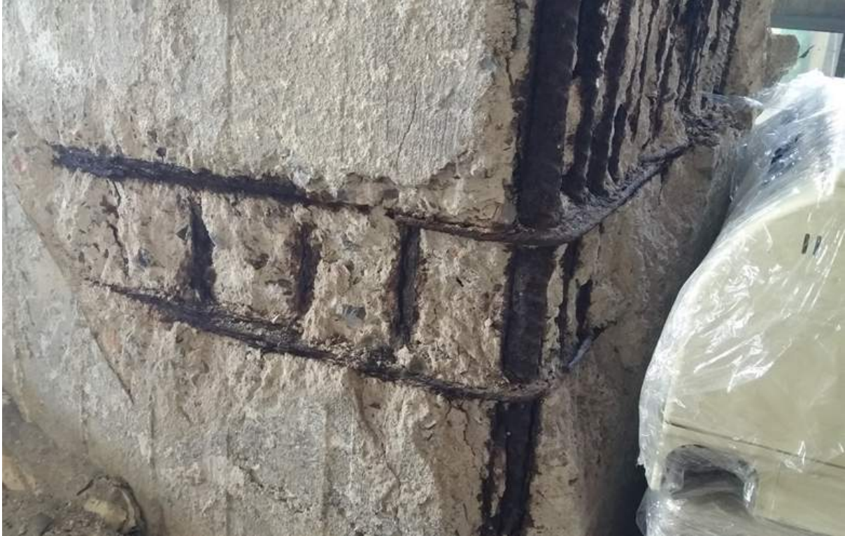
Şekil 28: A ve C Blok kolonlarında oluşan korozyona örnekler (bina dışı ve içi)
