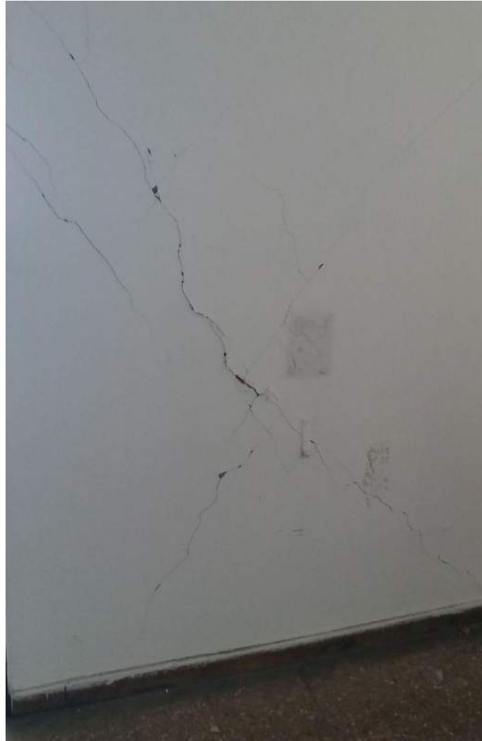
Şekil 31 Bölme duvarlarda oluşan hasarlara örnekler
