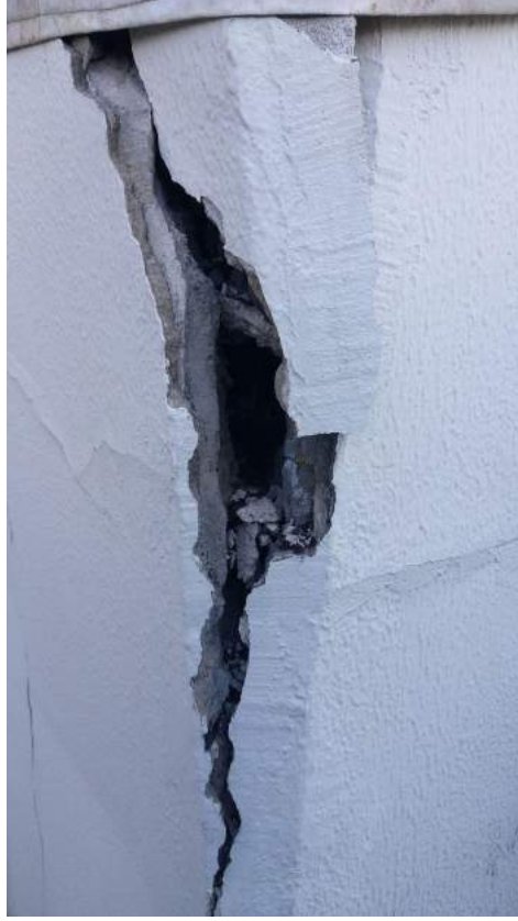
Şekil 29 Korozyon nedeni ile oluşan paspayı kırılması
