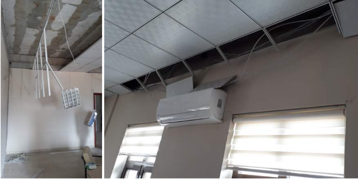
Şekil 54. 2018 Deprem Yönetmeliği 'ne göre inşa edilmiş bir belediye binasında 2020 Elazığ depremi sonrasında gözlenmiş yapısal olmayan hasarlar
